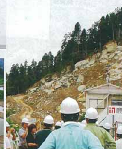
妙見崩れ現場
